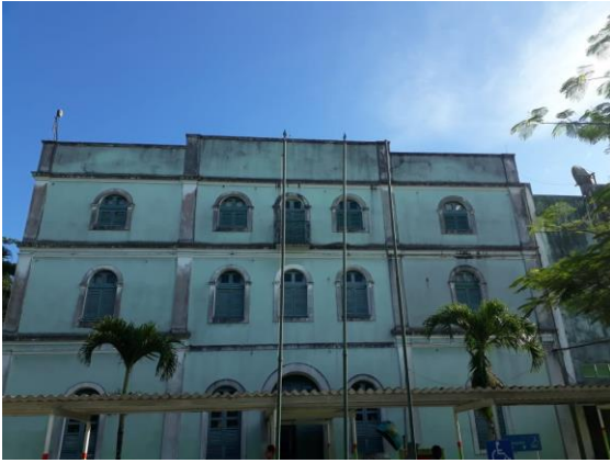
5 – Fachada sem SPDA
