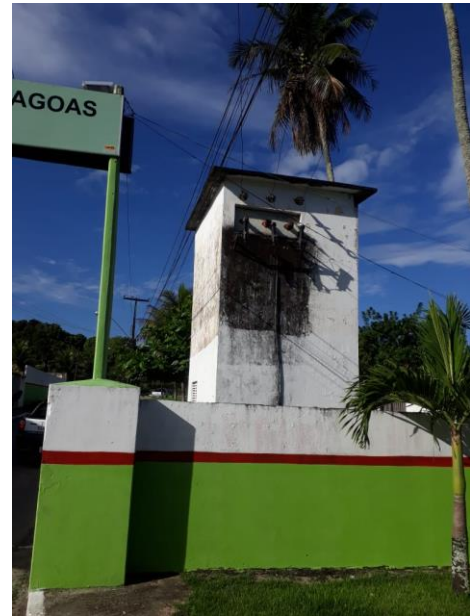
2 – Medição e proteção em média tensão
