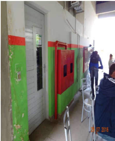
Abrigo com hidrantes já instalados
