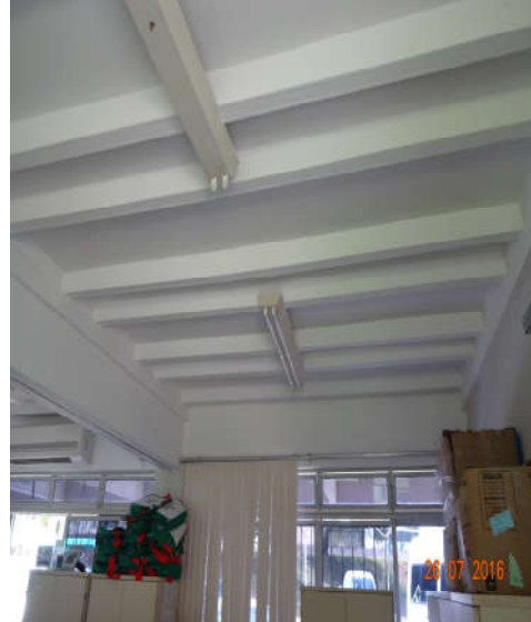
Sala onde terá detectores de fumaça
