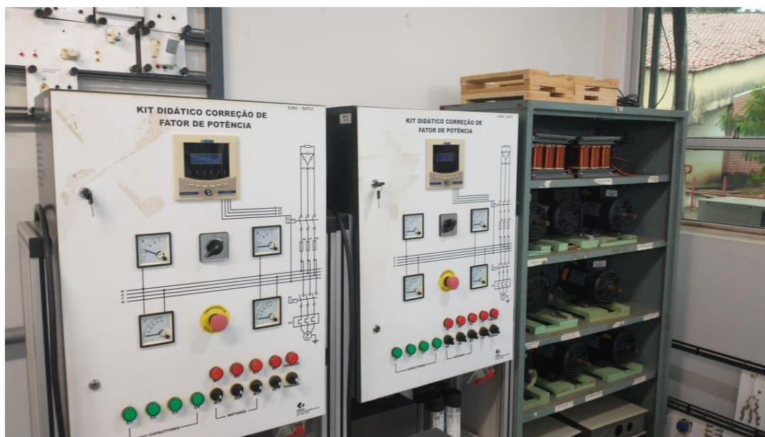
Figura 2-Laboratorio de instalações elétricas / eficiência energética
