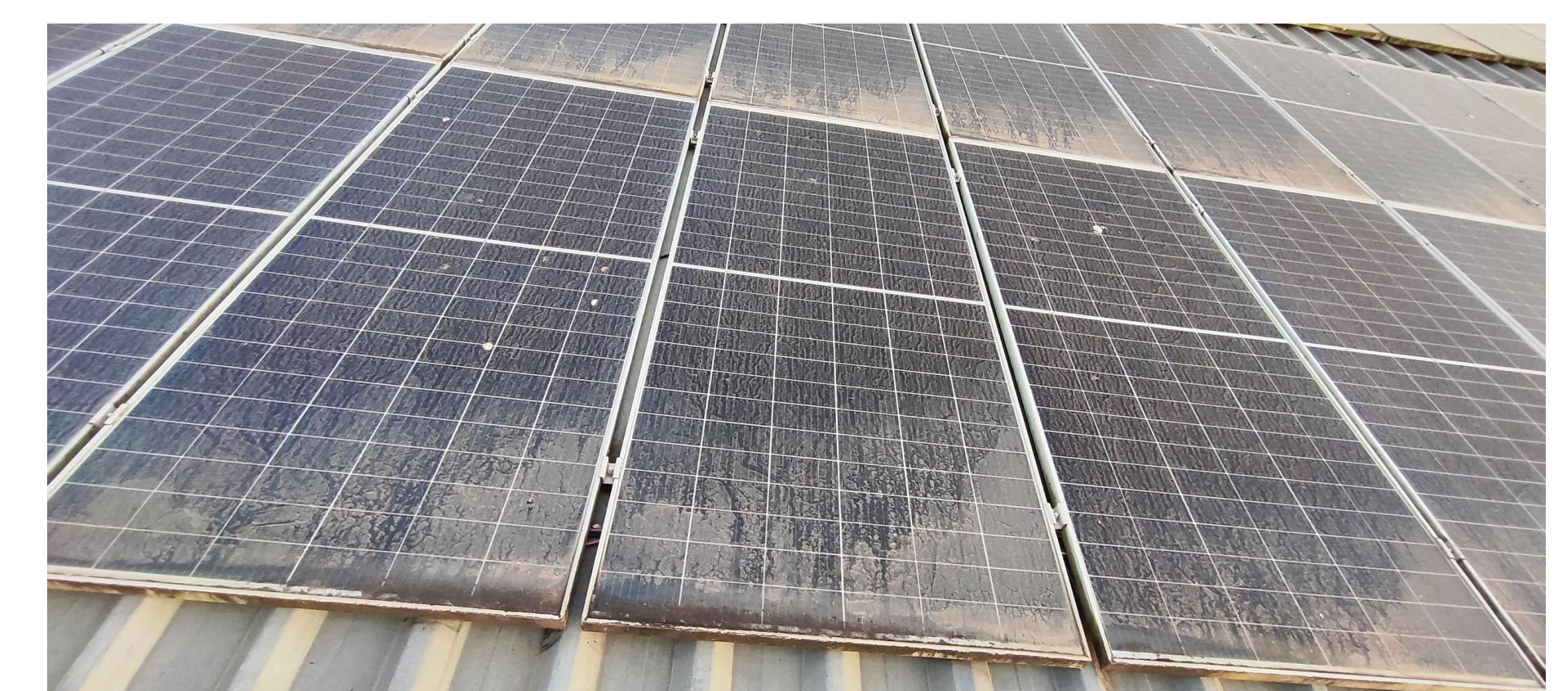
Figura 3 – Sujidade nas placas solares (Autores, 2024).
