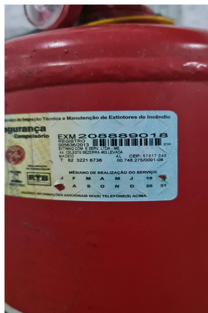
Figura 2: extintor de incêndio vencido
