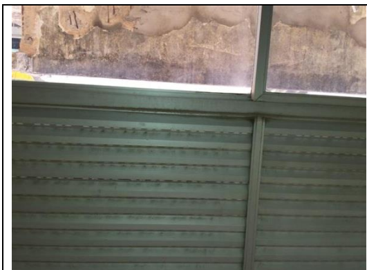
Figura 9 - Janela com furos permitindo vazamento de ar refrigerado, Maceió (AL), 01 de outubro de 2015.
