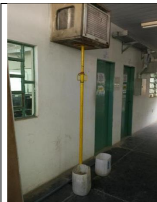
Figura 14 - Aparelho de ar sustentado inapropriadamente por escoramento metálico e água de saída pingando num balde, Maceió (AL), 01 de outubro de 2015.
