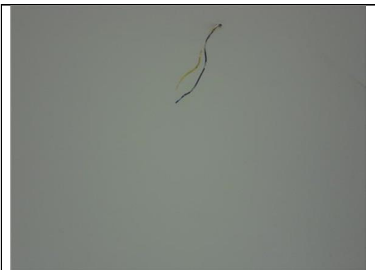
Figura 1 - Fio exposto no teto, Penedo (AL), 09 de outubro de 2015.
