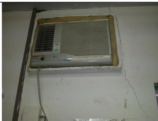
Figura 15 - Rachadura na parede de sustentação do aparelho de ar condicionado, Maceió (AL), 01 de outubro de 2015.
