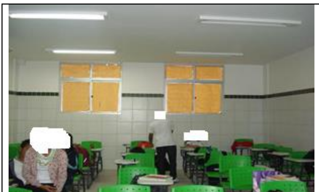
Figura 6 - Lâmpadas queimadas e ausência de cortinas, Penedo (AL), 09 de outubro de 2015.
