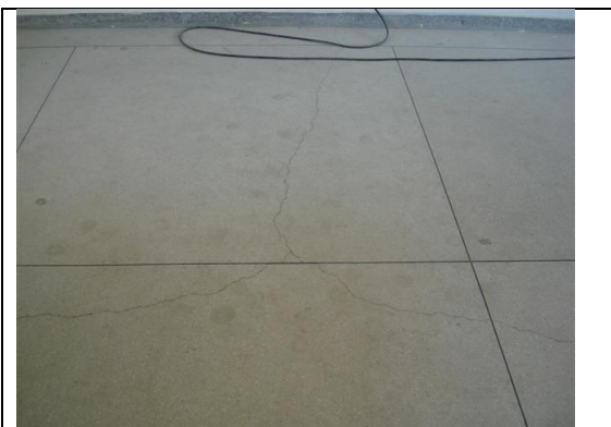
Figura 2 - Rachaduras no piso da sala de aula, Penedo (AL), 09 de outubro de 2015.
