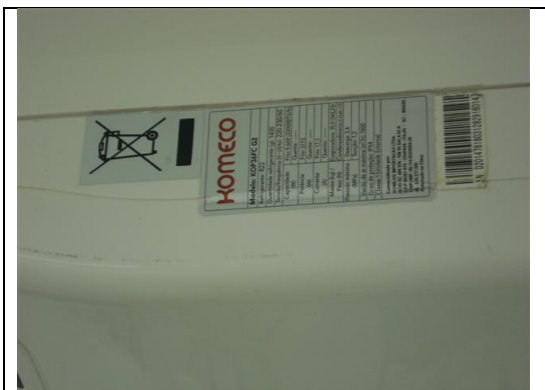
Figura 3 - N° de patrimônio de ar condicionado avariado emitindo forte barulho quando ligado Penedo (AL), 09 de outubro de 2015.
