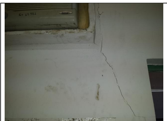
Figura 16 - Rachadura na parede, Maceió (AL), 01 de outubro de 2015.
