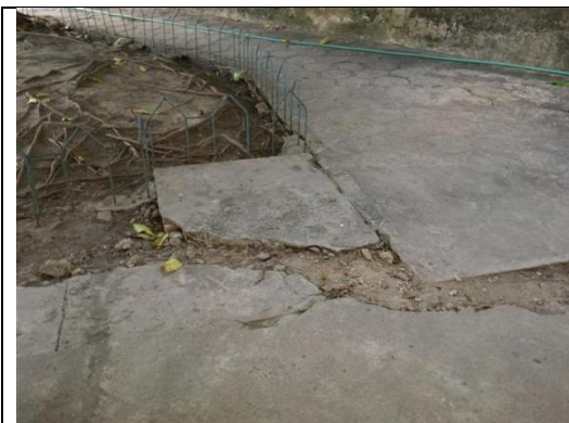
Figura 17 - Calçada de acesso à sala com descontinuidade, Maceió (AL), 01 de outubro de 2015.
